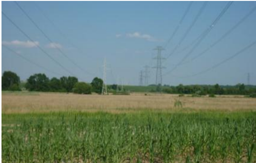
Рисунок 44: Коридор повітряної ЛЕП 400кВ Печ-держваний кордон, з опорами типу «ЯЛИНА».
