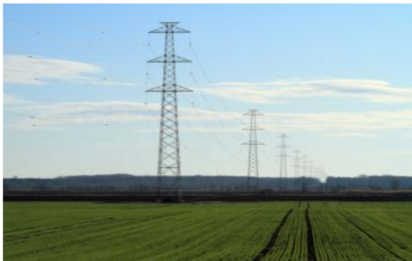
Рисунок 43: Повітряна ЛЕП 400кВ Мартонвашар-Дьйор з опорами типу «ЯЛИНА».
